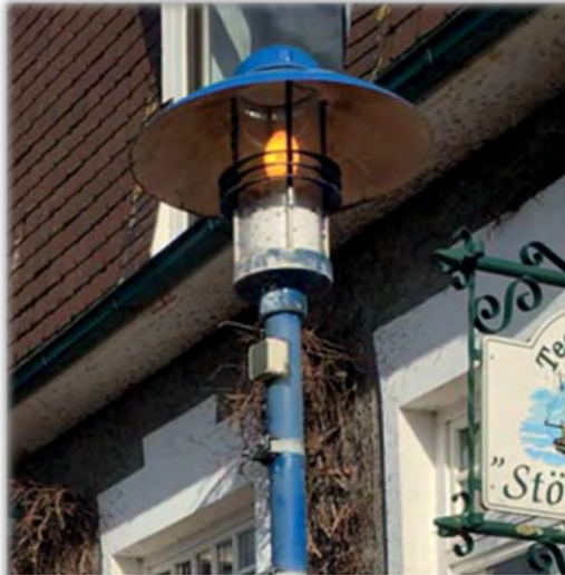
Bestandsleuchte mit Natriumdampf-Lampe
